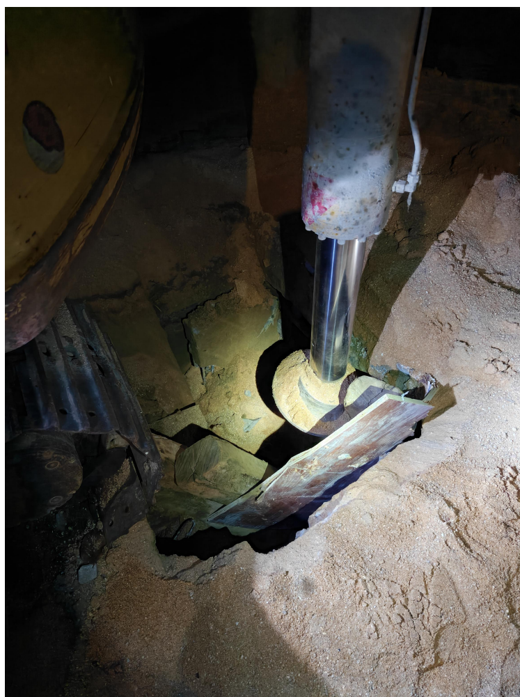
皖 E14480 水泥泵车右前方支架塌陷处概貌照片
