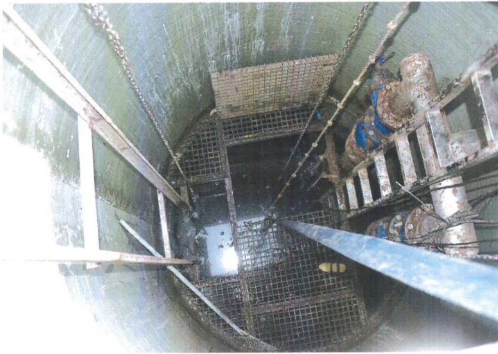
泵站内概貌照片
