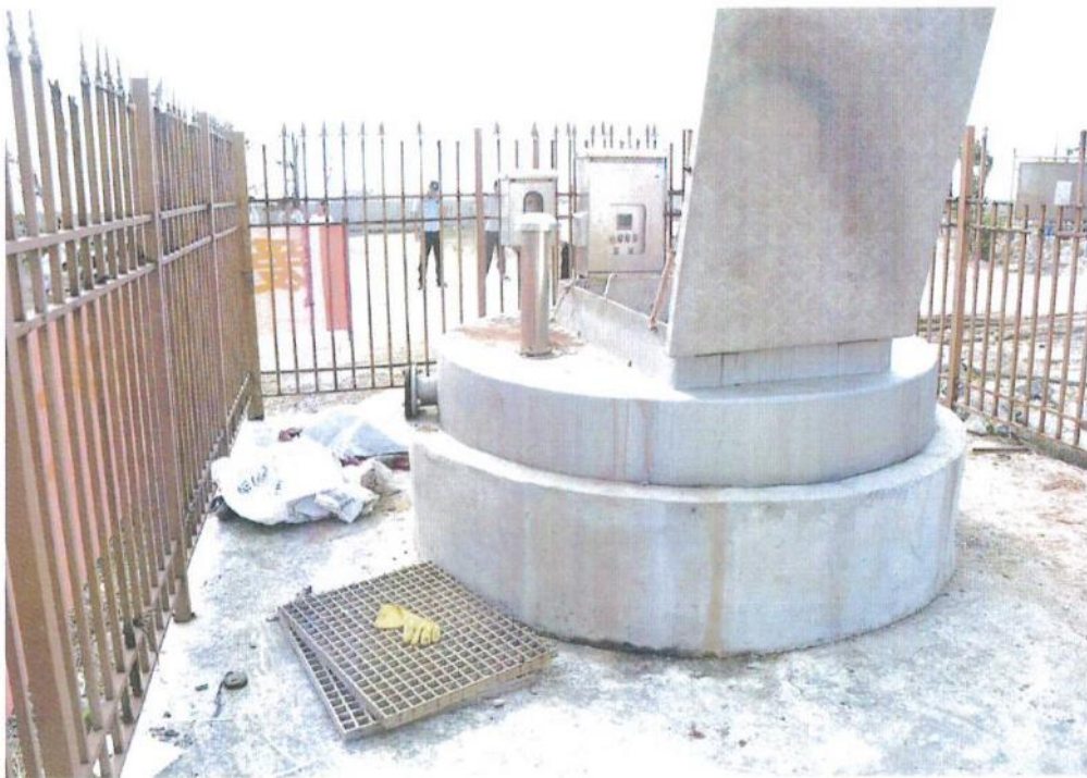
污水处理工程 3#一体化泵站概貌照片
